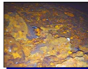
地下タンク内部の腐蝕状況(貯油中)
